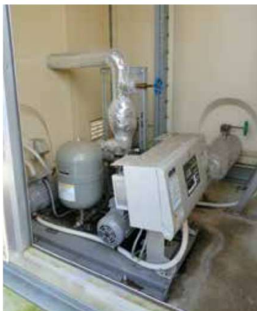
加圧給水ポンプで常に一定の水圧を保つ
